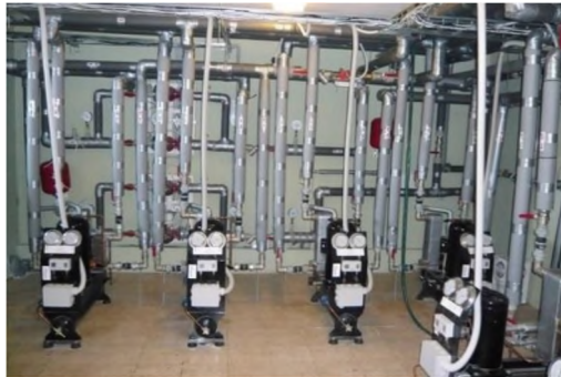
Рис. 3.19. Тепловые насосы в энергоэффективном здании
